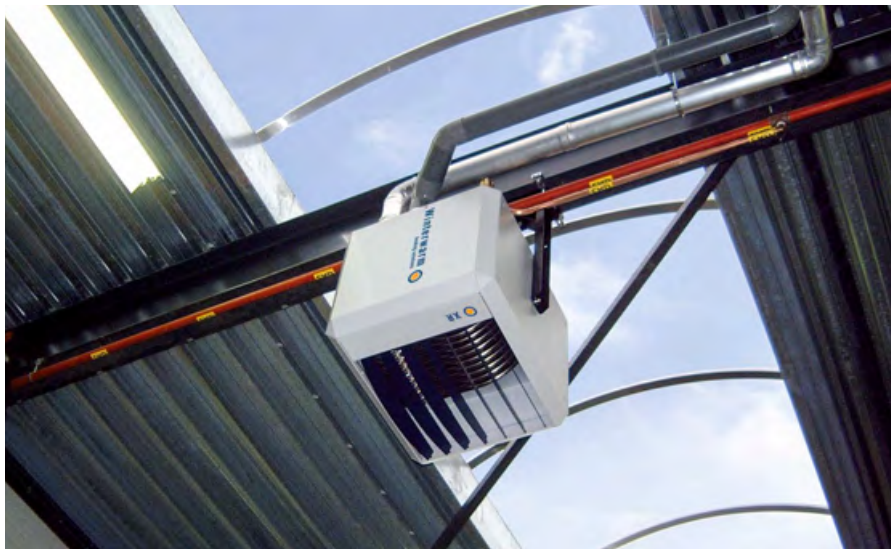
❖ Фото 2. Газовый воздушонагреватель, смонтированный под углом
