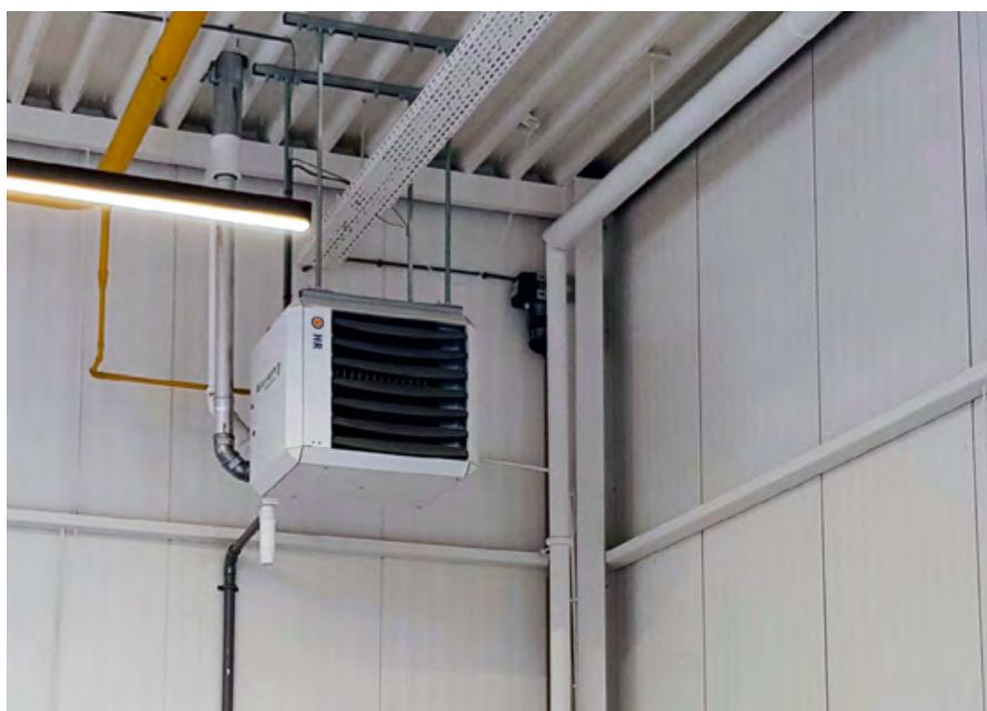
❖ Фото 3. Конденсационный газовый воздушонагреватель
