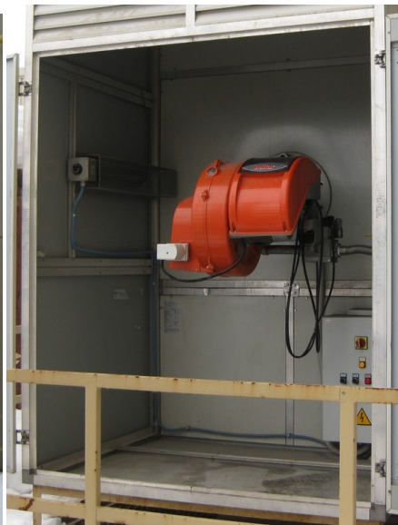
❖❖ Фото 7. Вид внутри секции с горелкой
