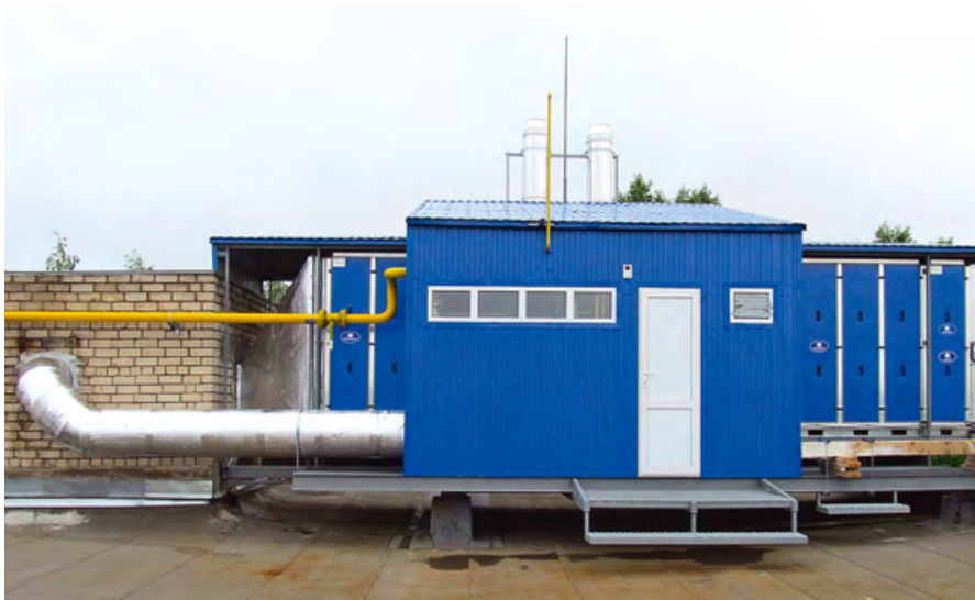
❖ Фото 3. Приточная установка со встроенными газовыми секциями нагрева
