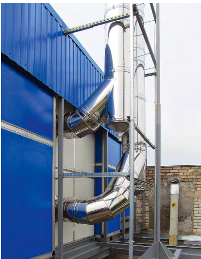
❖ Фото 4. Вид дымоходов с конденсатоотводчиками в тройниках
